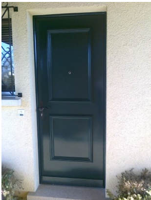
Porte d'entrée principale vétuste...
